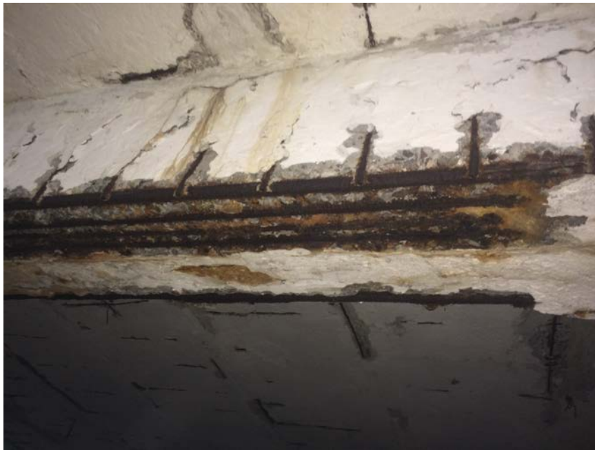
Рисунок 2 - Пошкодження зумовлені порушенням технологічного процесу виготовлення.
