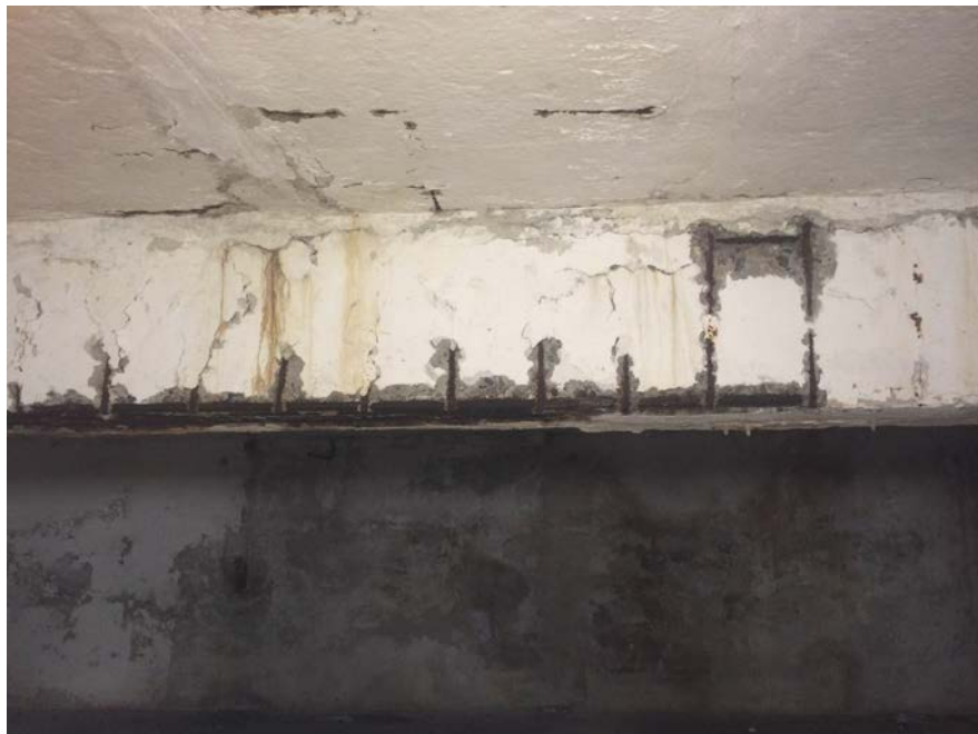
Рисунок 1 - Пошкодження центрального несучого ригеля.
