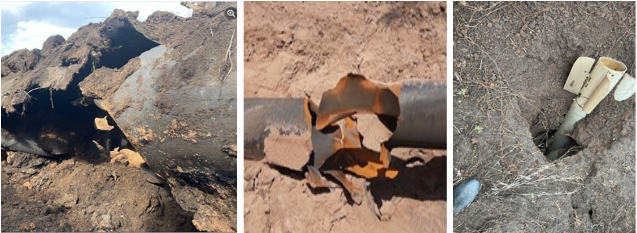
Рисунок 1. – Порушення роботи газогону на Харківщина, який був пошкоджений агресором і виконання ремонтних робіт співробітниками Оператора ГТС України
